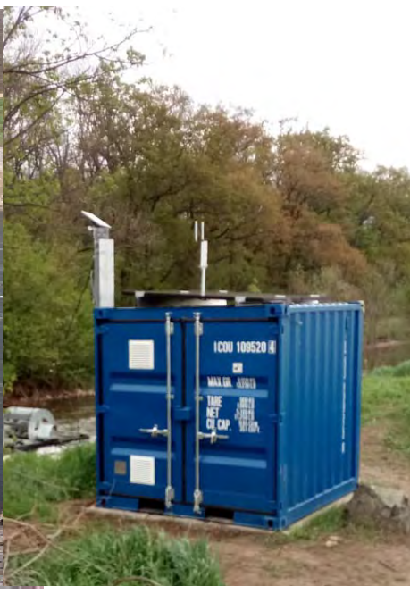
Basisstation mit Solar, Speicher & Fernüber- wachung
